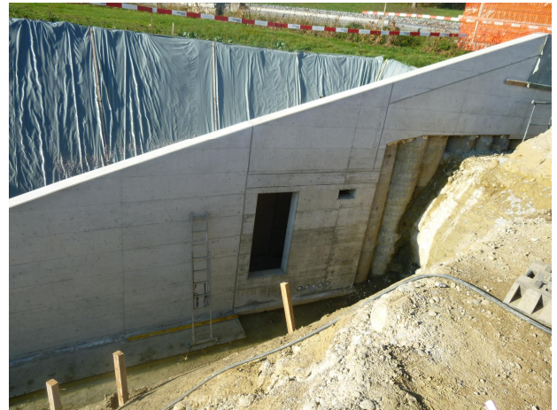
Portal Süd mit Elektrozentrale
